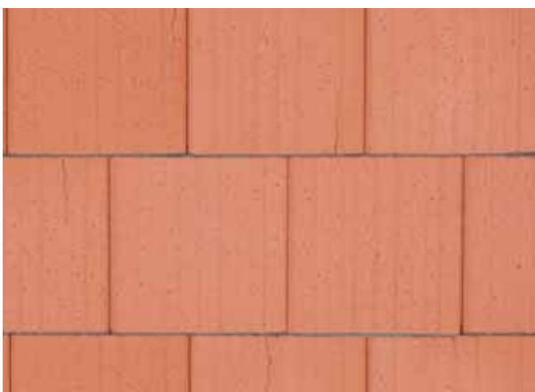
Bild 12: Ziegelmauerwerk mit Trocknungs- oder Brennrissen
